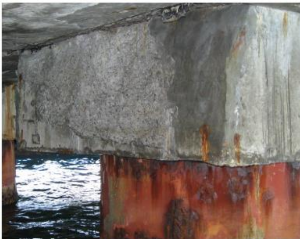
Рис. 3.5. Свая № 26Б. Скол бетона капители глубиной до 50 мм, высотой 600 мм, шириной 1800 мм
