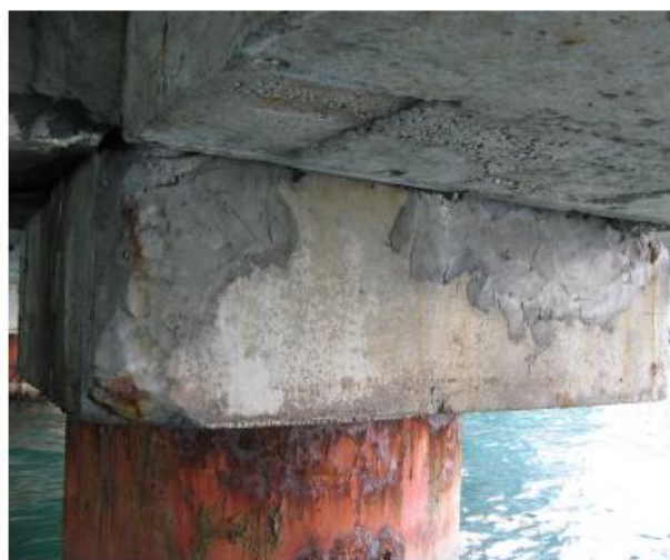
Рис. 3.3. Свая № 13Г. Сколы бетона капители глубиной до 100 мм (частично покрыты торкретом)
