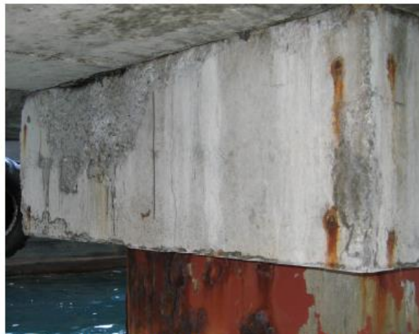
Рис. Свая № 26Г. Скол бетона капители глубиной до 50 мм, высотой 400 мм, шириной 700 мм
